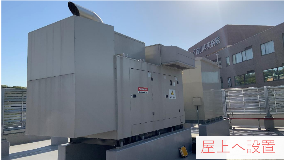
自家発電装置、重油タンク(1950L)
