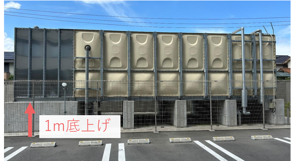
貯水槽、給水ポンプ
